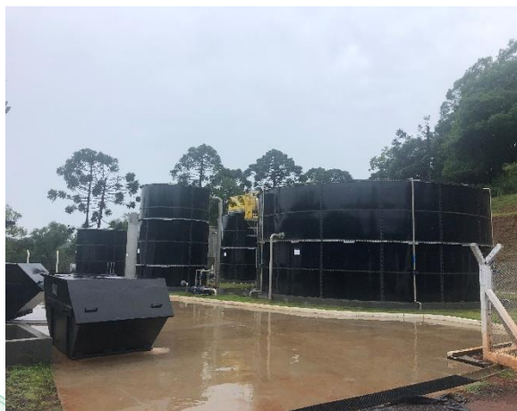
Figura 25 - Vista dos tanques de tratamento
