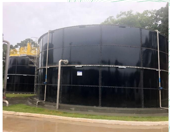
Figura 26 - Vista dos tanques de tratamento
