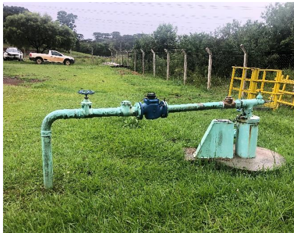
Figura 17 - Captação Subterrânea de Turvo - PR
