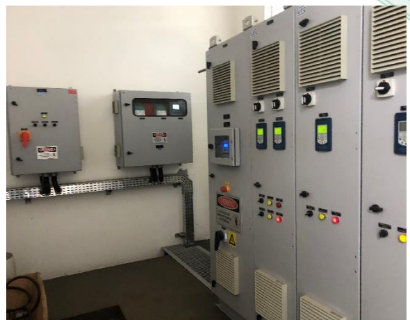
Figura 28 - Central de controle da ETE de Turvo-PR
