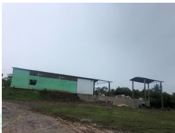
Figura 39 - Referentes ao galpão de triagem de resíduos do município de Turvo – PR.
